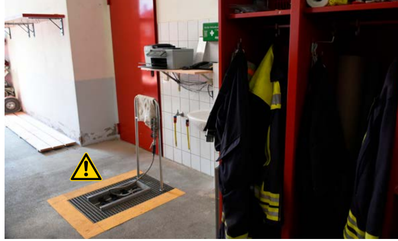
Bild 13 Stiefelwäsche als Hindernis im Alarmweg
