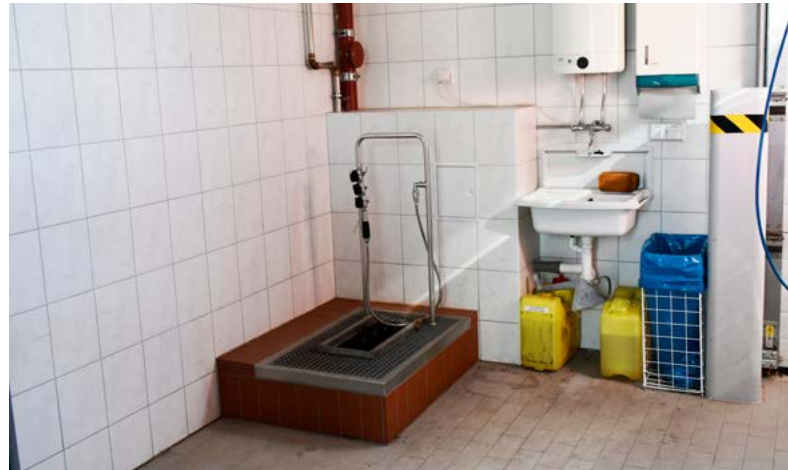
Bild 14 Stiefelwäsche außerhalb des Verkehrsweges
