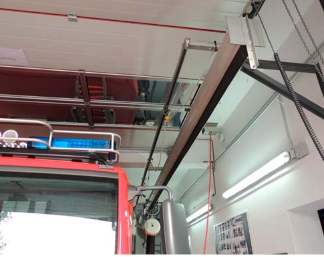
Bild 26 Führung der Laufschiene für die Abgasabsaugung unter der oberen Torhalterung
