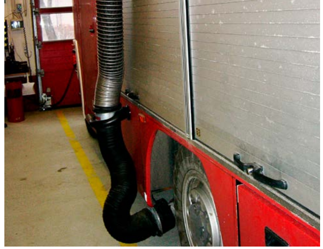
Bild 27 Regelkonform installierte Abgasabsaugung
