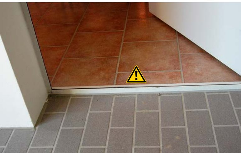
Bild 10 Stolperstelle im Eingang ins Feuerwehrhaus
