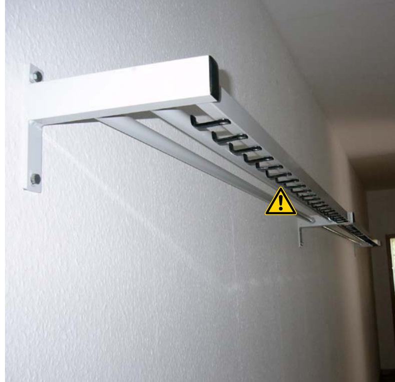
Bild 9 Garderobenhaken in Augenhöhe bilden Verletzungsgefahren
