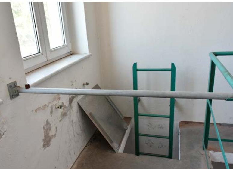
Bild 49 Einzelfalllösung am Arbeitspodest zur Sicherung gegen Absturz
