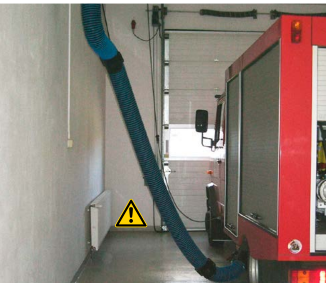
Bild 28 und 29 Durch Abgasschläuche versperrte Verkehrswege
