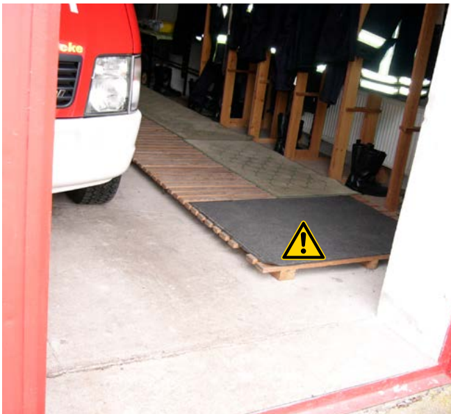
Bild 17 Diese Konstruktion birgt Umknick- oder Stolpergefahr
